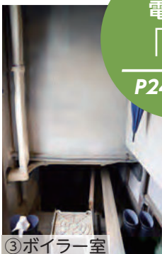
③ ボイラー室
