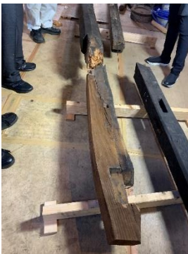
折れた隅木(左)と隅木の上に立っていた束(右)
